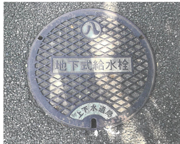
地下式給水栓
